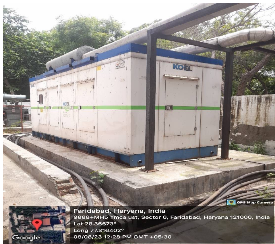
Fig-9.1: DG Set 500 KVA
